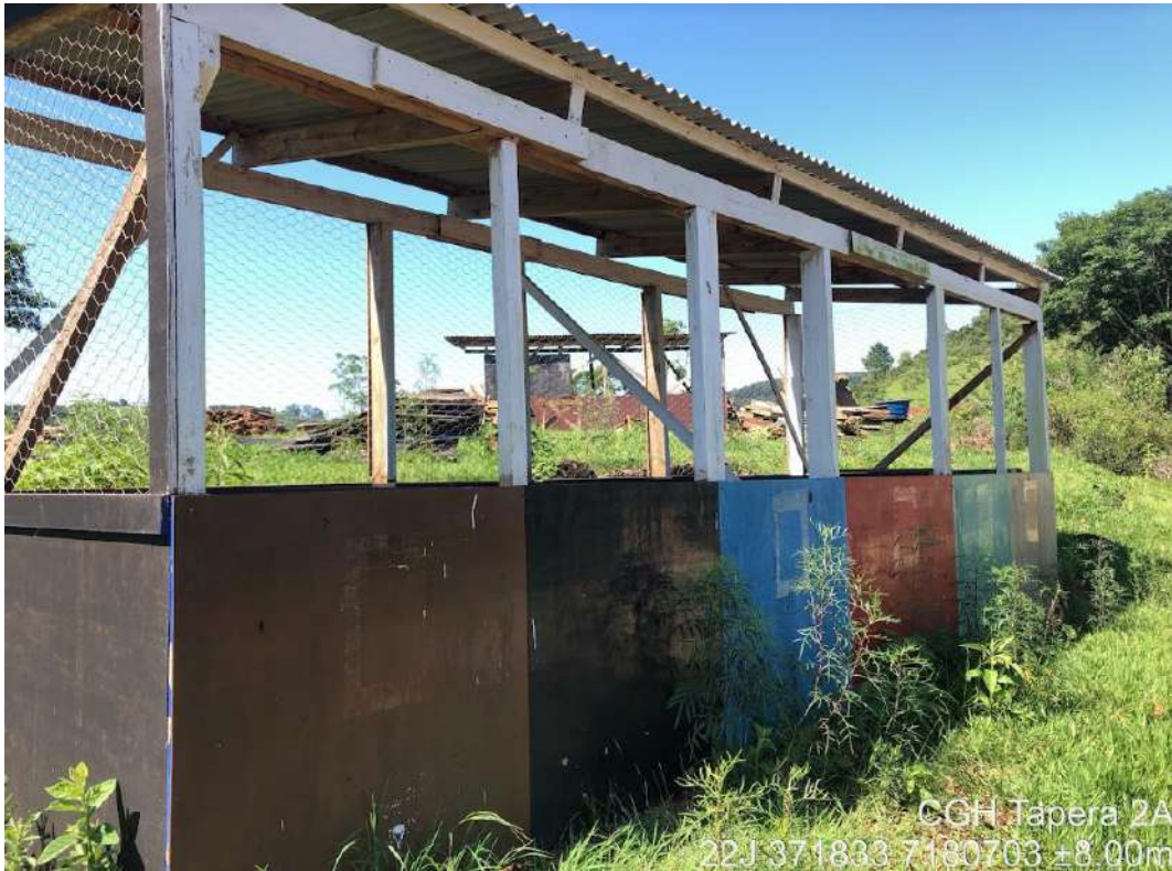
Figura 7 - Coletores para a segregação de resíduos na CGH Tapera 2A.
