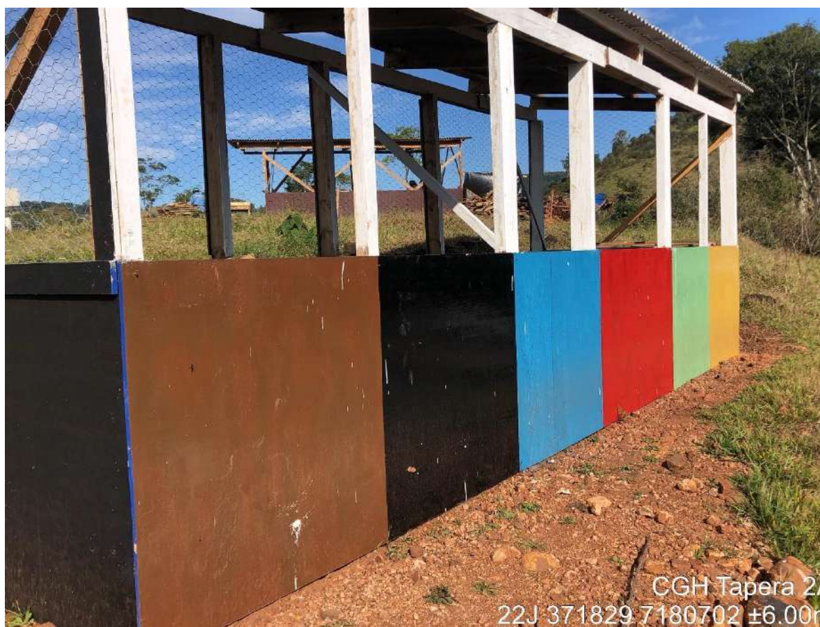
Figura 8 - Baias de armazenamento de resíduos.
