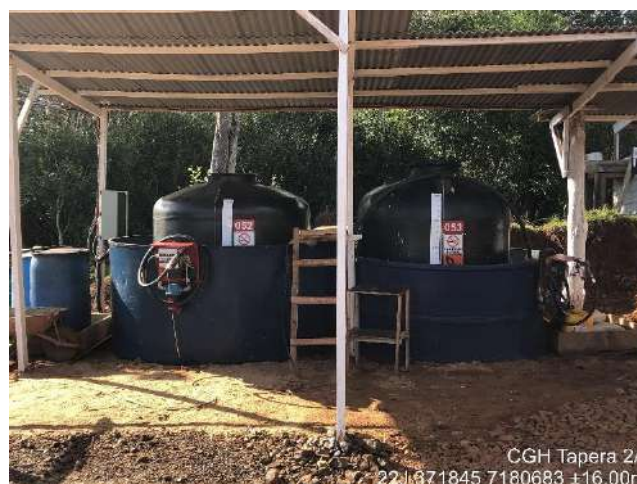
Figura 2 - Área para armazenamento de óleo e panos usados.
